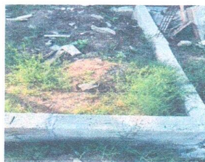
Foto 4: Se observa la necesidad de elevar las paredes de este módulo, por falta de presupuesto ya no se continuó.
