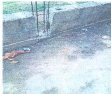
Foto 2: Se observa la necesidad de elevar las paredes de este módulo, por falta de presupuesto ya no se continuó.
