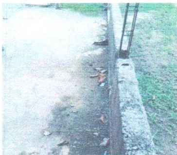
Foto 1: Se observa la necesidad de elevar las paredes de este módulo, por falta de presupuesto ya no se continuó.
